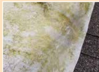
Op de grond geplaatst A1 object zonder enig onderhoud.
